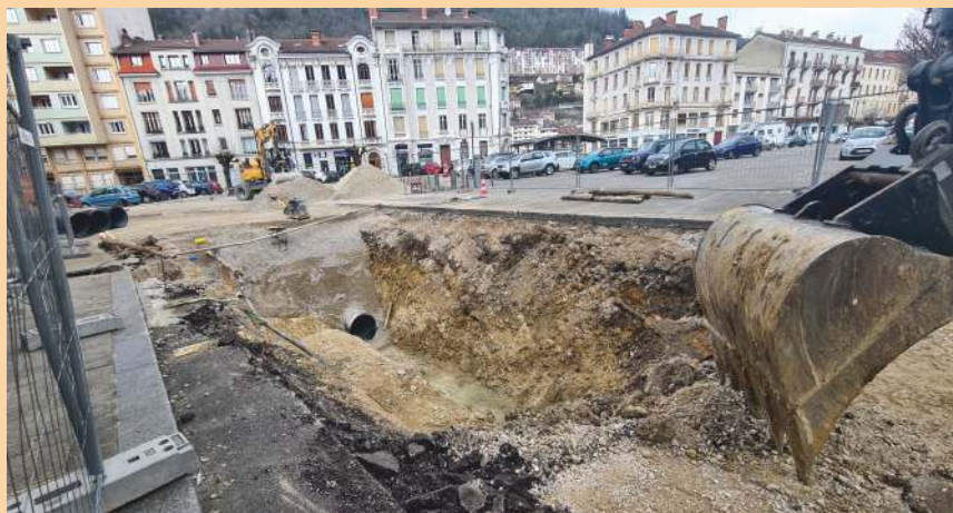
Après l'avenue de Belfort en 2023, les travaux d'assainissement se poursuivront cette année à Saint-Claude.
